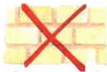
Le couleur du joint ne s'accorde pas avec celle de la pierre
